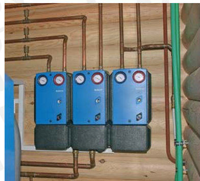
Котельная с "двухэтажной" компоновкой газового наддувного котла G215 - 47 кВт и бойлера LT 200 л. Автоматика 4211.
