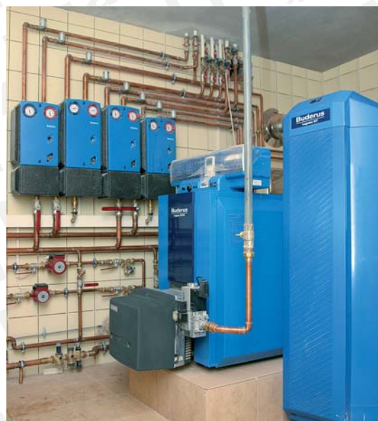
Котельная на базе газового наддувного котла G215 - 85 кВт. Бойлер ST 300 л., автоматика 4311.
