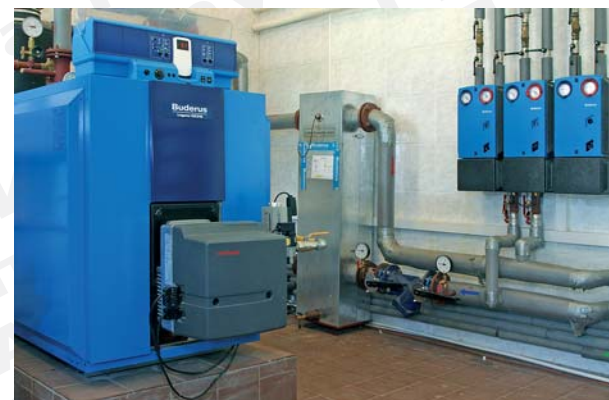
Двухкотельная установка на базе газовых наддувных котлов 2 x GE315 - 140 кВт. Гидравлический разделительный сосуд. Каскадная автоматика 4311/4312.
