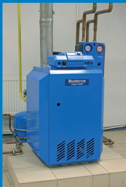
Топочная на базе газового атмосферного котла G124 - 32 кВт, автоматика 2107.
