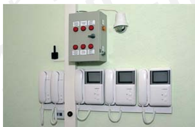
Диспетчерский пульт дистанционного контроля работы котельной.
